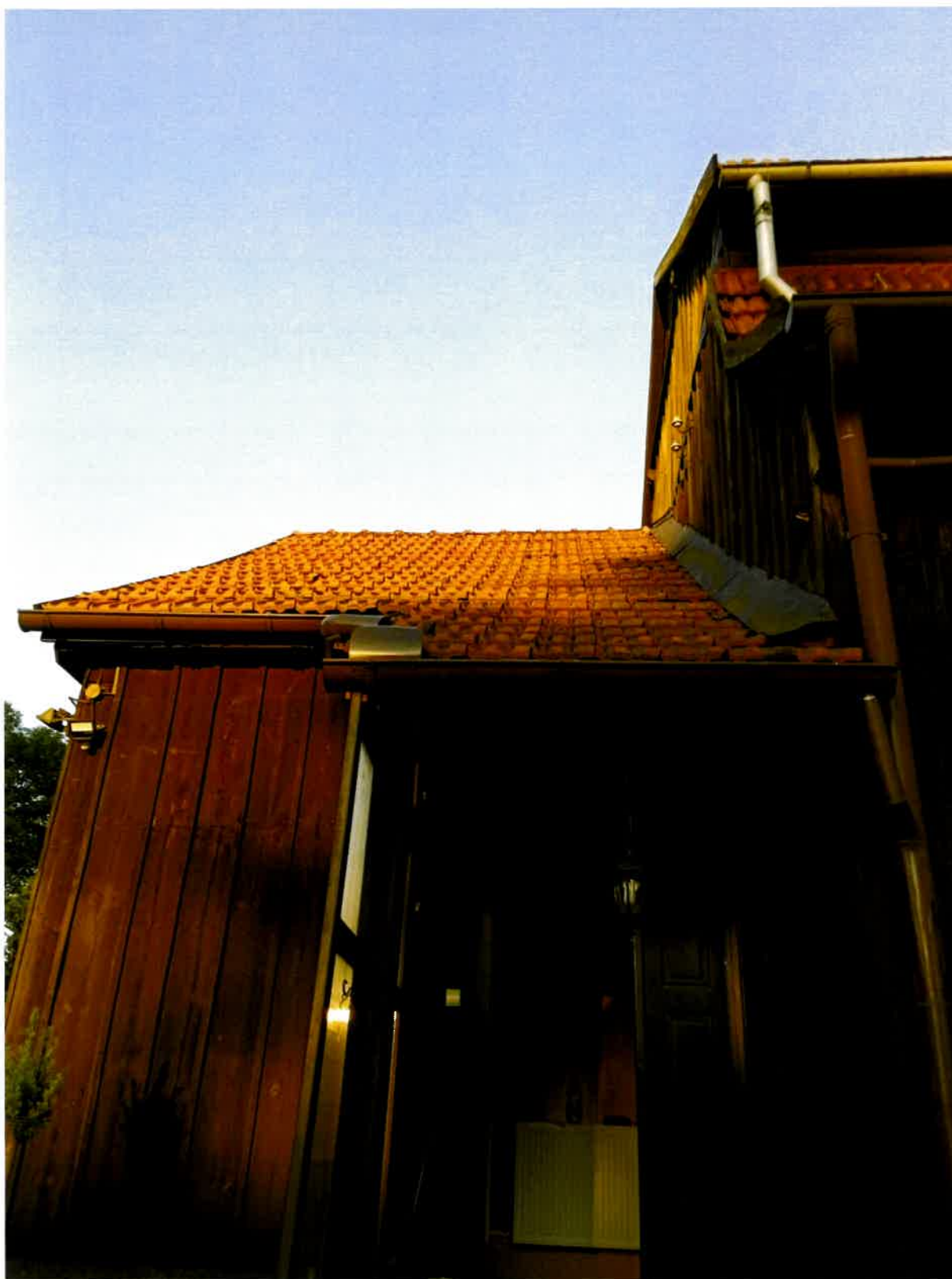
Fot.9 Zespół kościoła pw. Św. Mikołaja w Chróście, elewacja tylna plebanii, zbliżenie stanu desek szalunkowych.
